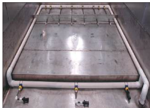
冷水盘清洗配管
