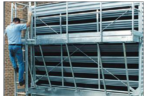
外部检修平台及爬梯
