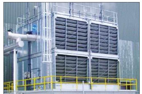
外部爬梯、安全鼠笼及安全扶手
