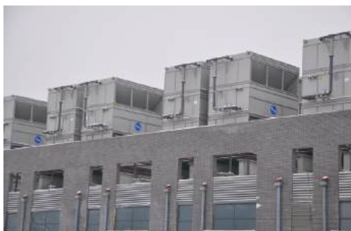
数据中心调控系统
