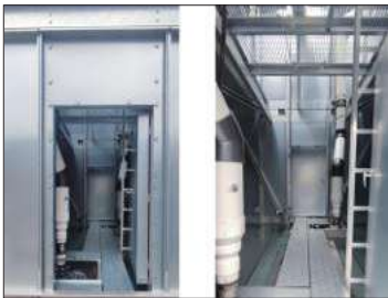
大检修门及宽敞的检修空间
