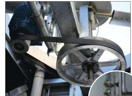
位于检修门旁带润滑嘴的 加长润滑油管路
