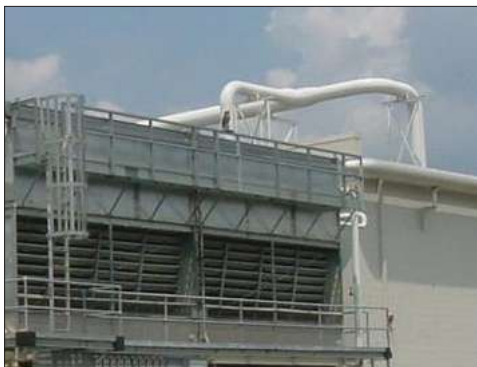
外部检修平台及爬梯
